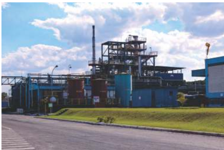
Incinerador - Essencis Taboão da Serra
